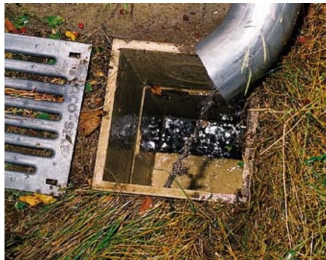
Přítok dešťové vody do rýhy
