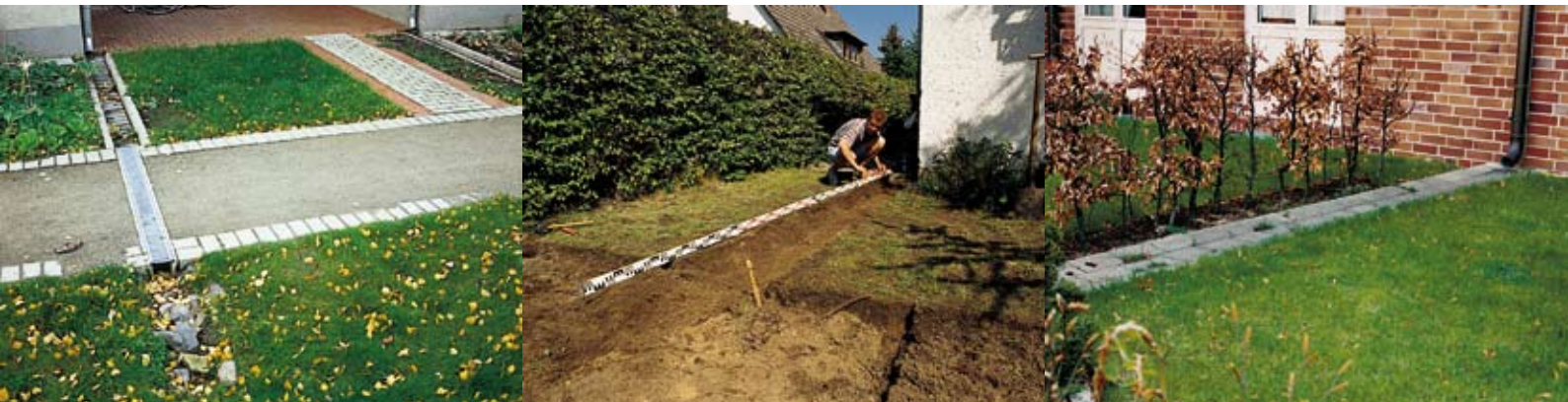
Povrchový přívod dešťové vody do průlehu
